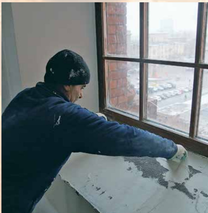
С видом на город с высоты птичьего полета. Отделочные работы под куполом
