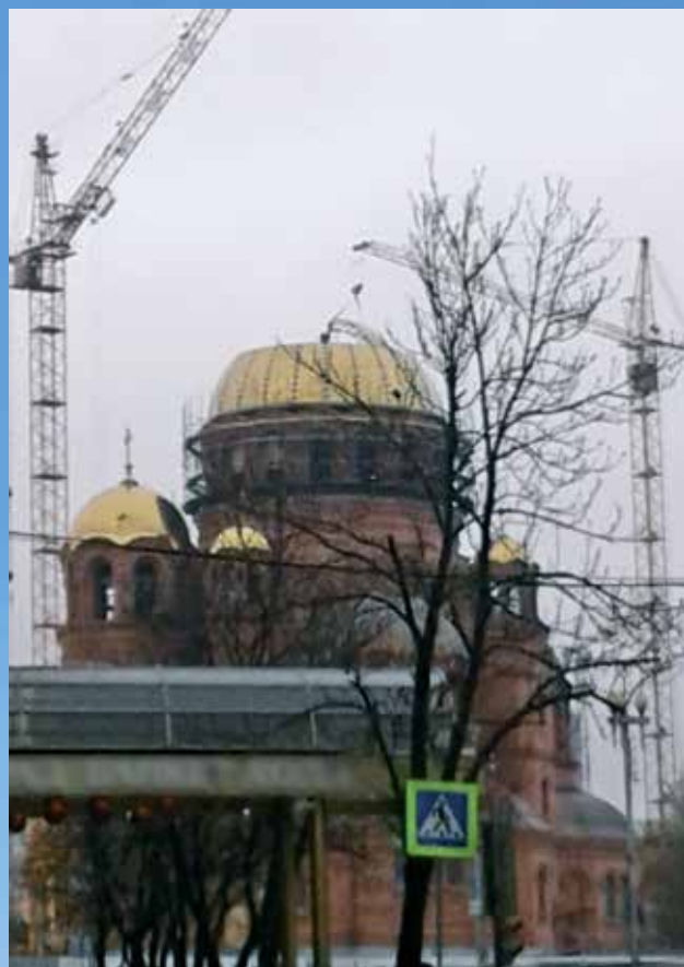
Декабрь 2019 год. Сборка главного купола, изготовленного в Волгодонске, производилась по особой технологии.
